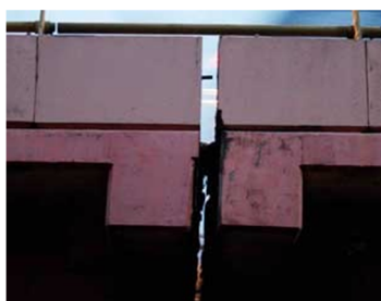
Gambar 1. Siar Muai Jembatan yang Terputus
