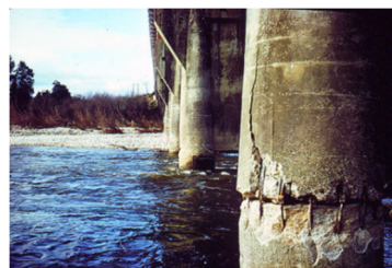
Gambar 3. Retak Berat Pada Struktur Pilar
